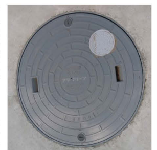
▲マンホールトイレに対応したフジクリーン仕様のマンホール
