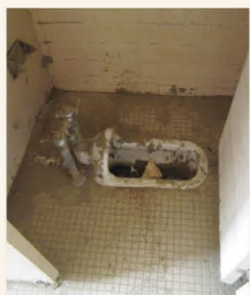
▲水洗機能を失った和式便器
