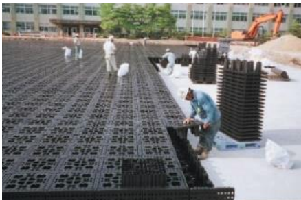
校庭に設置された貯留施設
