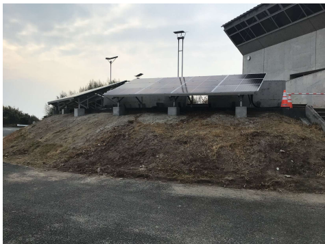
太陽光発電システム
