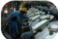
【両津火力発電所】
