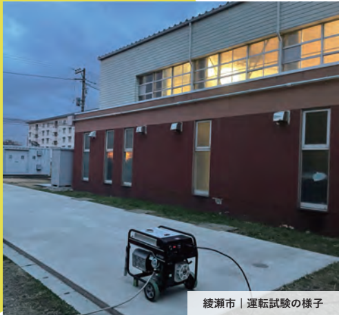
綾瀬市 | 運転試験の様子
