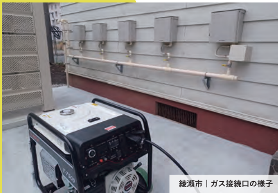
綾瀬市 | ガス接続口の様子
