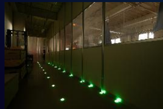
工場の避難誘導灯
